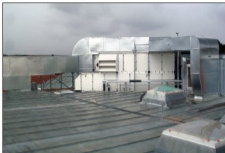
Am höchsten Punkt der Klinik: Zentrale Lüftungsanlage mit hocheffizienter Wärmerückgewinnung für Heiz- und Kühlfunktionen über den Dächern der Stadt. □
